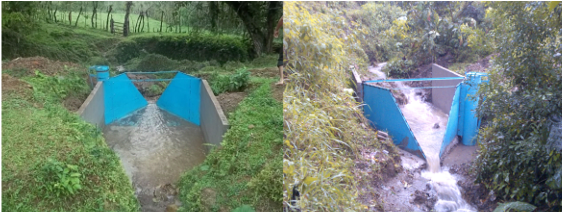
Figura 17: Aforador tipo H4.5 en funcionamiento.
