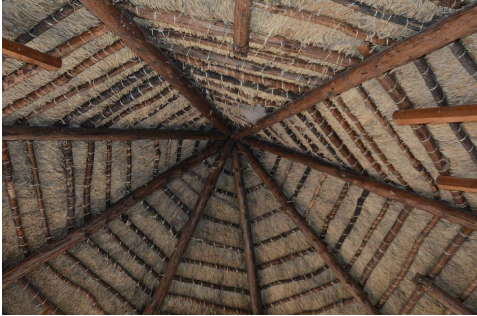
Figura 16. Techo y estructura de una bioconstrucción, que se encuentra dentro del Proyecto San Isidro en Tlaxco, Tlaxcala.
