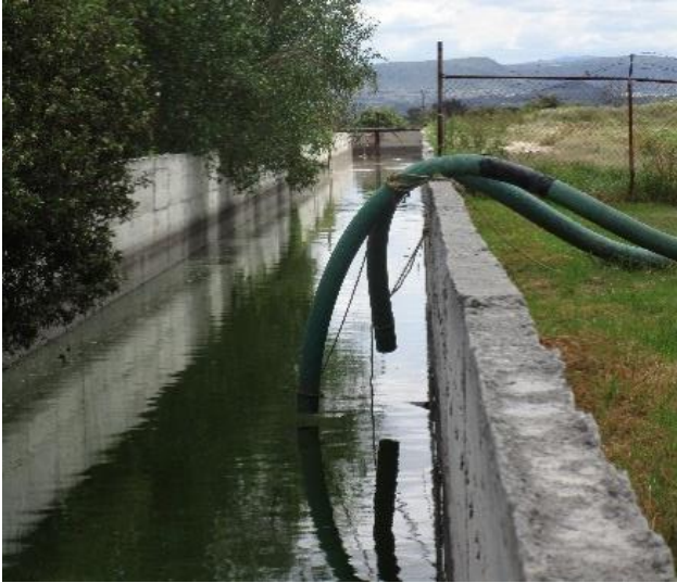
Foto 7.- Lugar donde se instalan las bombas para controlar las inundaciones, en Tuzos, colector de aguas negras de El Venado, Mineral de la Reforma, Hidalgo, foto tomada en trabajo de campo, 2018.
