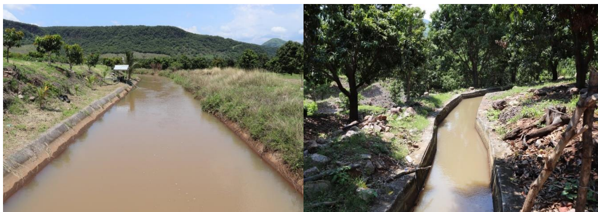
Figura 11. Canal principal y acequias ubicadas en la comunidad de Los Cajones Michoacán
