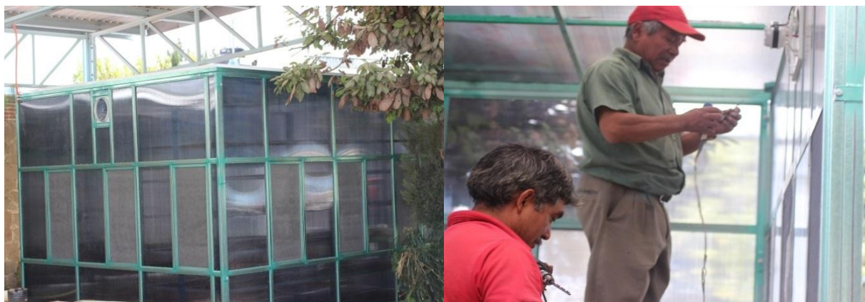
Figura 7. Construcción del módulo de deshidratación. A: parte externa con paredes de policarbonato y ventanas con malla plástica. B: colocación del extractor de aire eléctrico en lo alto de una pared del módulo.
