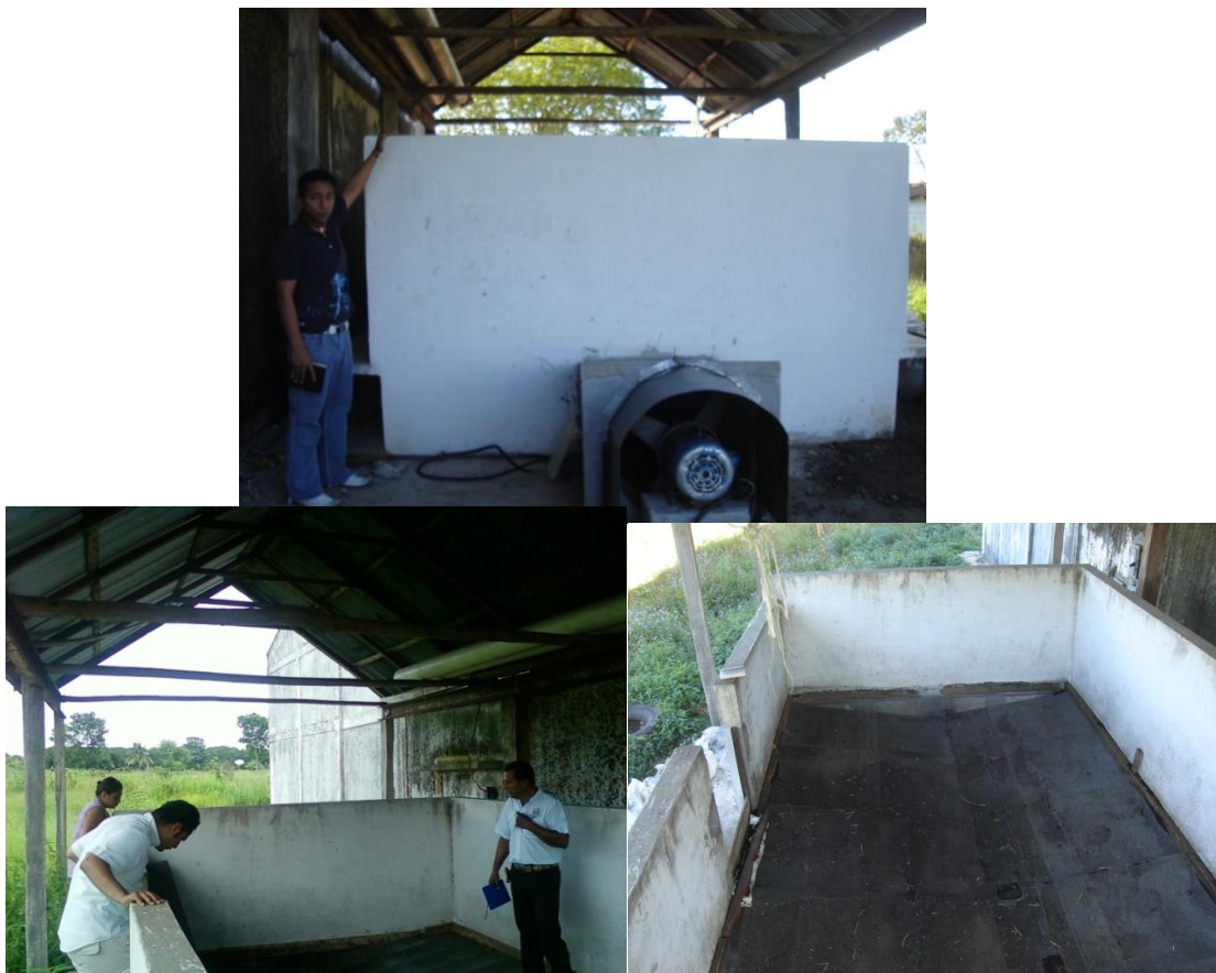
Fotografía 26. Pre-secadores de concreto
