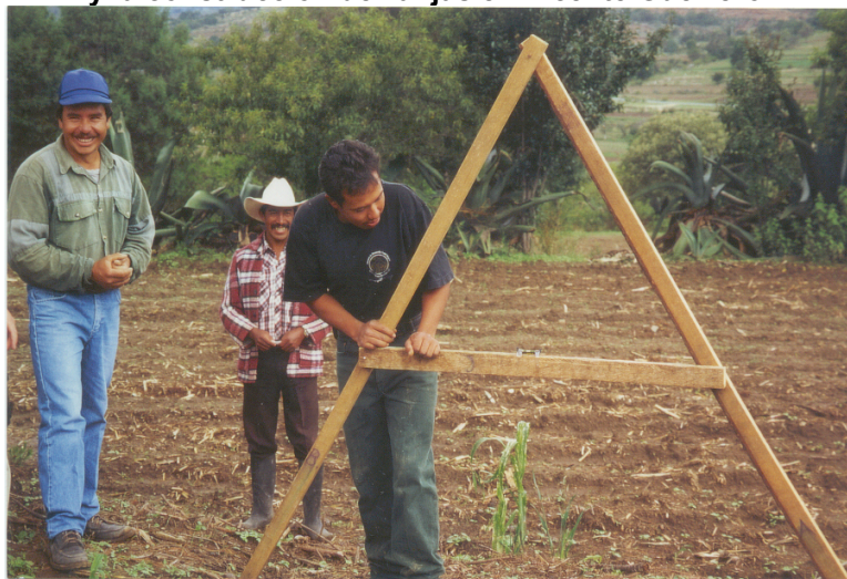
Figura 5.13. El trazo de curvas a nivel con el aparato “A” y la construcción de zanjas en Vicente Guerrero.
