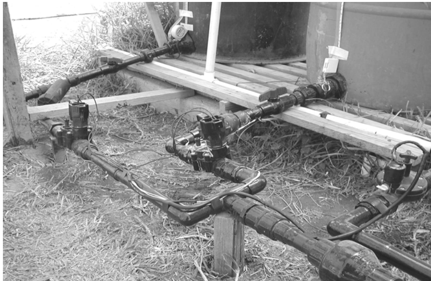
Figura 18. Válvulas solenoides instaladas en el cabezal del sistema de fertirrigación.
